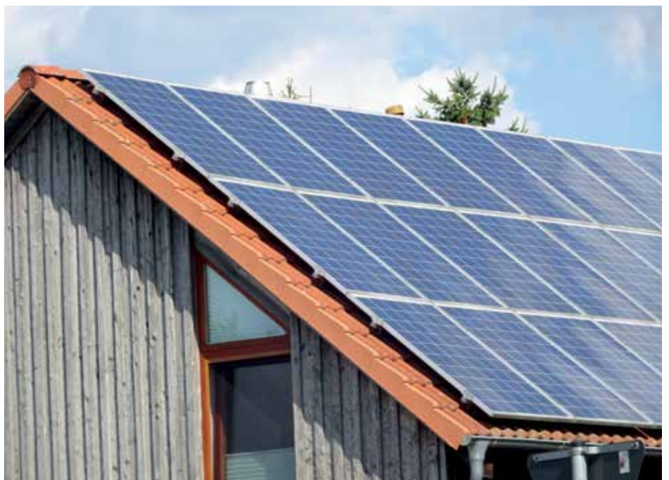
Fotovoltaik auf einem Neubau mit Satteldach
