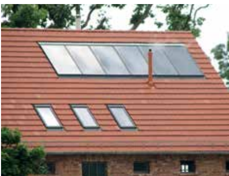
Solaranlagen mit schwarzer Rahmung beim Gut Groß Fredenwalde
